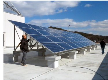
【大槌消防署の太陽光発電設備】
