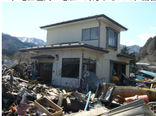
【被災した旧平田駐在所】
